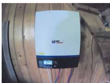
Nieuwe omvormer voor de zonnepanelen.
