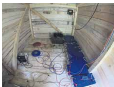
Overzicht foto van de batterijen in de nieuwe bunker.
